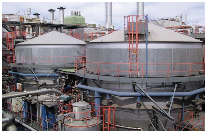
Das Klärschlammkraftwerk in Wien Simmering fungiert als »Rohstofflieferant«
