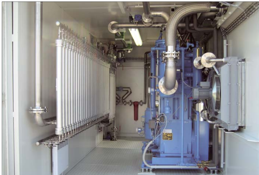
Innenansicht der Anlage in Bruck an der Leitha
