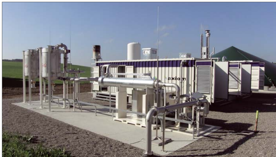
Aufbereitungsanlage in Kiblegg
