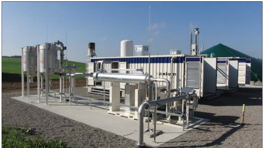
Aufbereitungsanlage in Kiblegg
