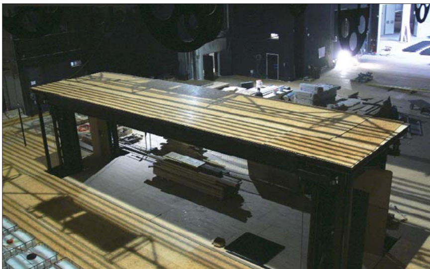
Blick auf die Bühne: Das hinterste der drei Hubpodien ist aus der Bühnenebene hochgefahren. Gut erkennbar die Doppelstockeinrichtung dieser Bühne.
