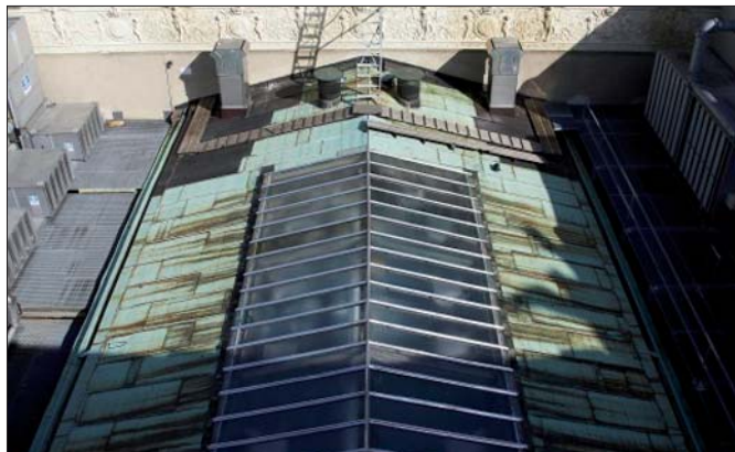
Schäden auf dem Parlamentsdach...
