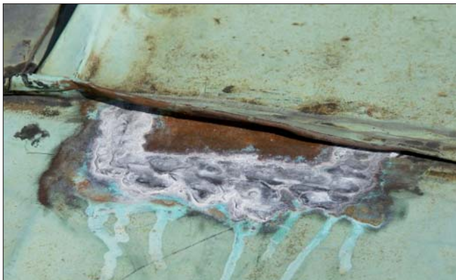
Schaden auf dem Dach über dem Nationalratssitzungssaal
