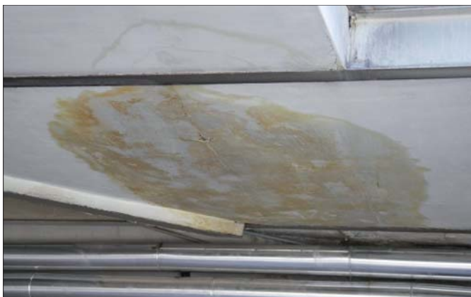
Große Feuchtigkeitsflecken nach Wasserschäden...
