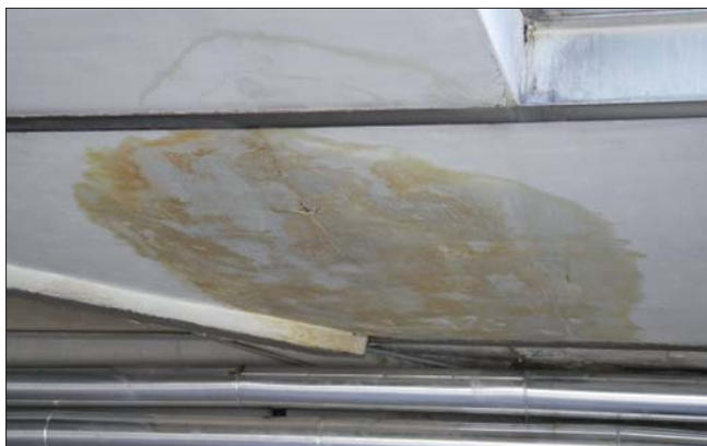
Große Feuchtigkeitsflecken nach Wasserschäden...
