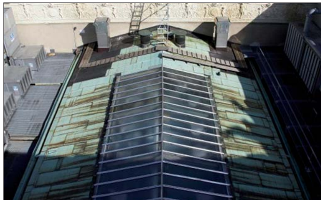
Schäden auf dem Parlamentsdach...
