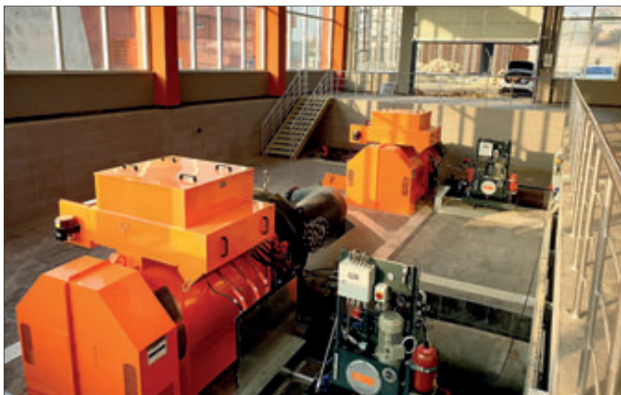
Foto: WWS Wasserkraft
