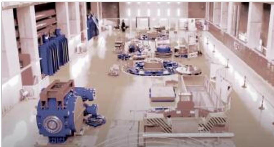
Ein Blick ins Innere des Kavernenkraftwerkhauses
